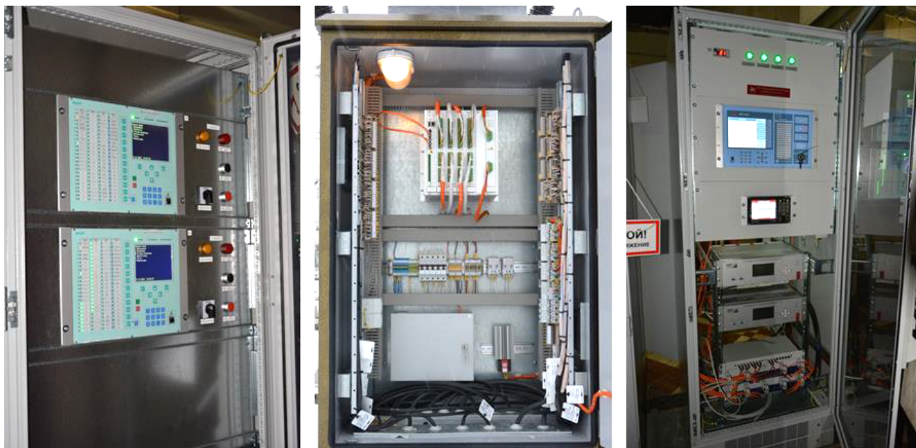
Рис. 1. Релейная защита блока генератор – трансформатор ШЭ1111 производства ООО «НПП ЭКРА», контроллер присоединения NPT Bay совместно с УСО NPT MicroRTU
