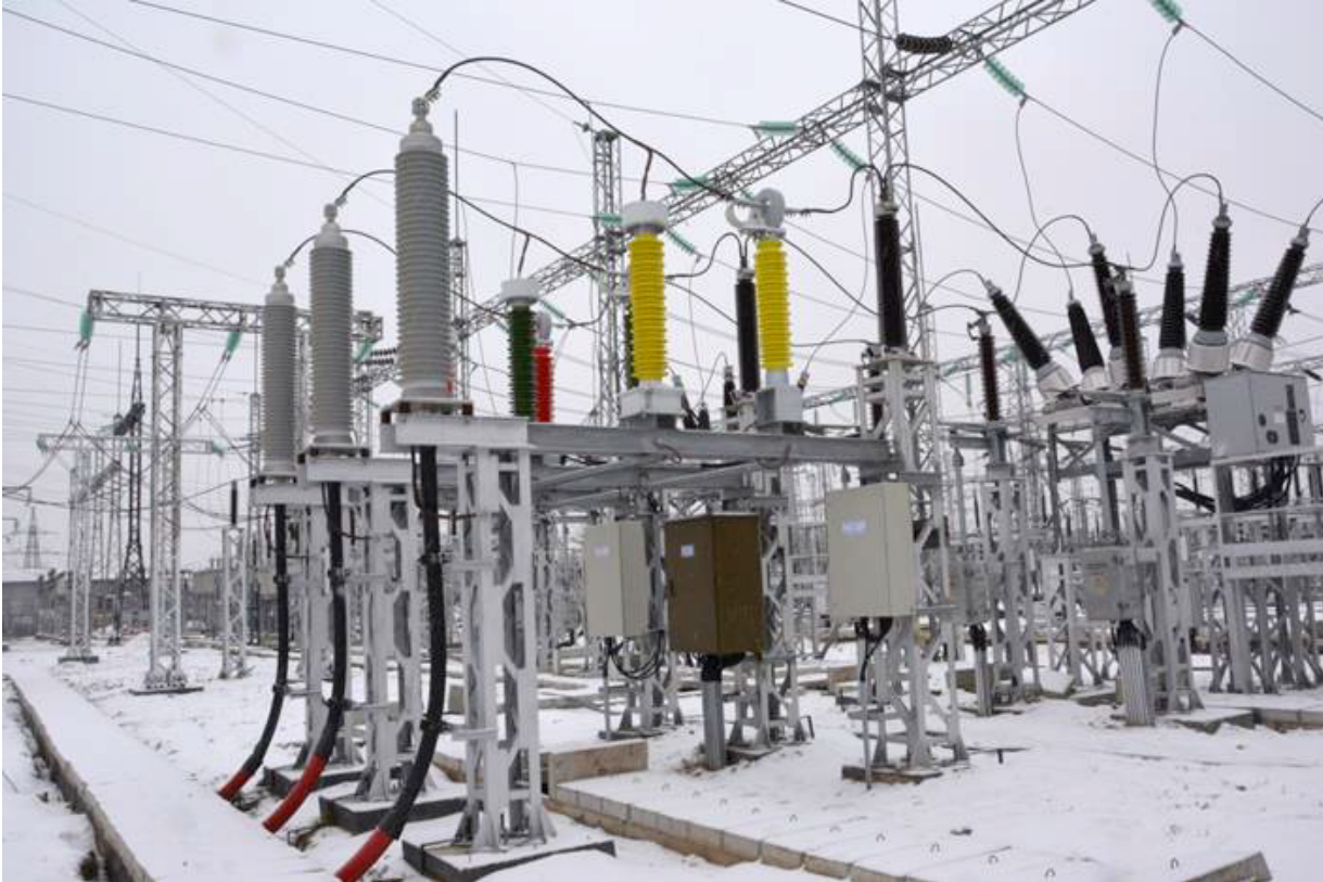
Рис. 2. Оптические ТТ и электронные ТН в цепи выключателя 110 кВ трансформатора
